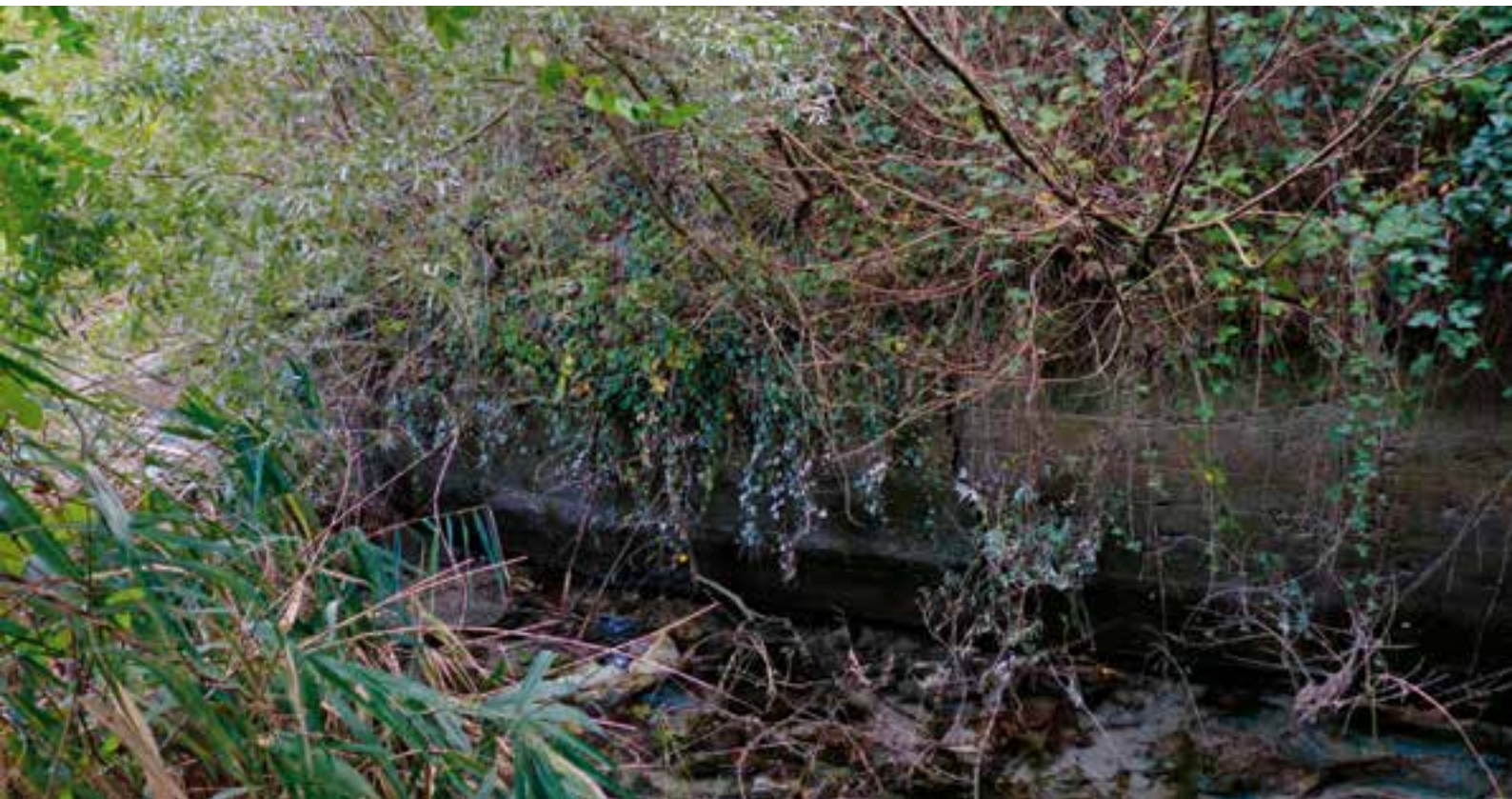
Il muro del canale di uscita dell'acqua dalla vecchia piscicoltura esiste ancora. Sotto quel muro si formavano le "tane" delle grosse marmorate di cui si parla nell'articolo. Oggi la zona è completamente inaccessibile.
